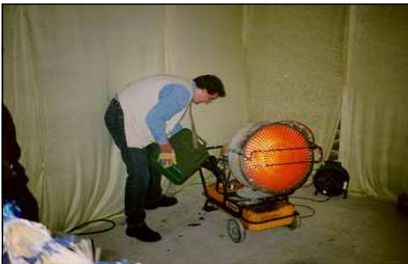
Die provisorische Heizung
